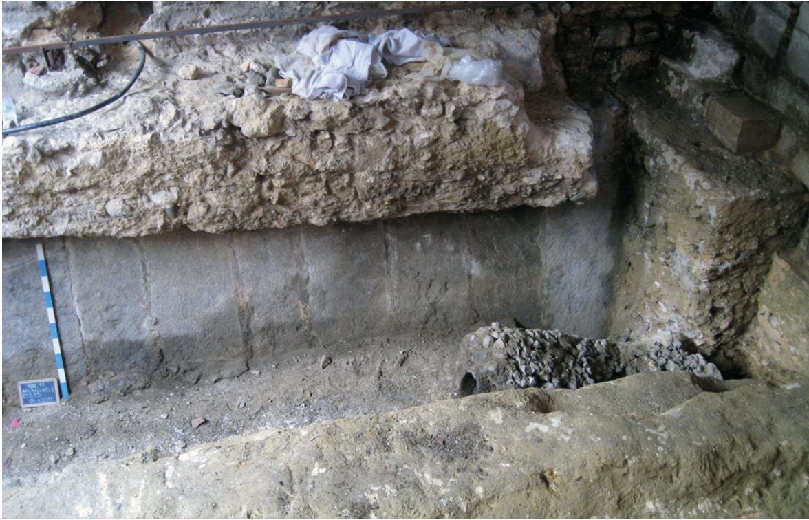
Figura 6 – Panorâmica geral do reforço estrutural da fachada Sul (Estruturas 12 e 15), observando-se no lado direito sobreposição do alicerce do arranque do botaréu sobre a Estrutura 15.
