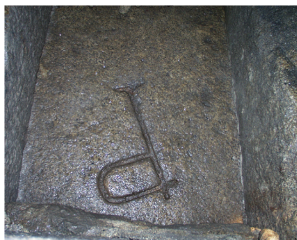
Figura 2 – Imagem de pedra gravada em baixo relevo com a letra “P”, ainda integrada no lajeado de cobertura do reservatório. Arquivo Metro do Porto, por Arq. Tomás Allen.
