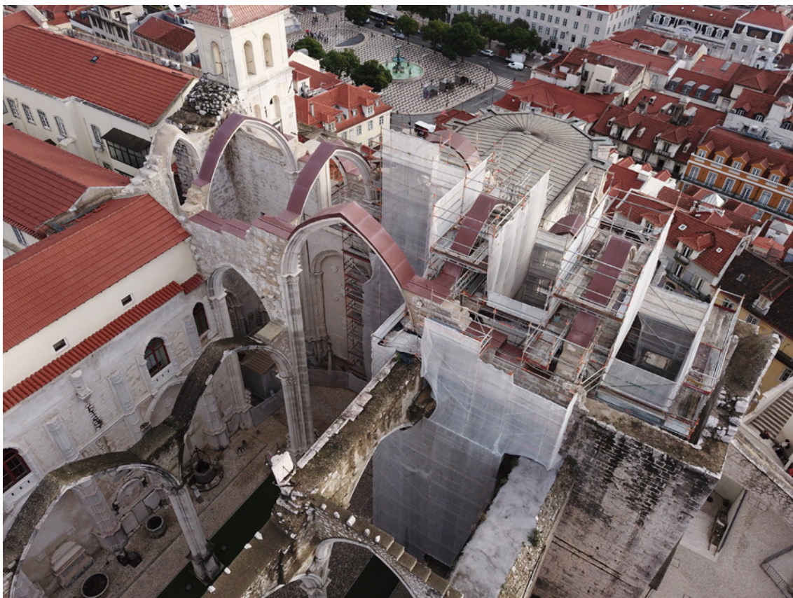
Figura 1 – Obras de conservação e restauro da zona do transepto do Museu Arqueológico do Carmo.
